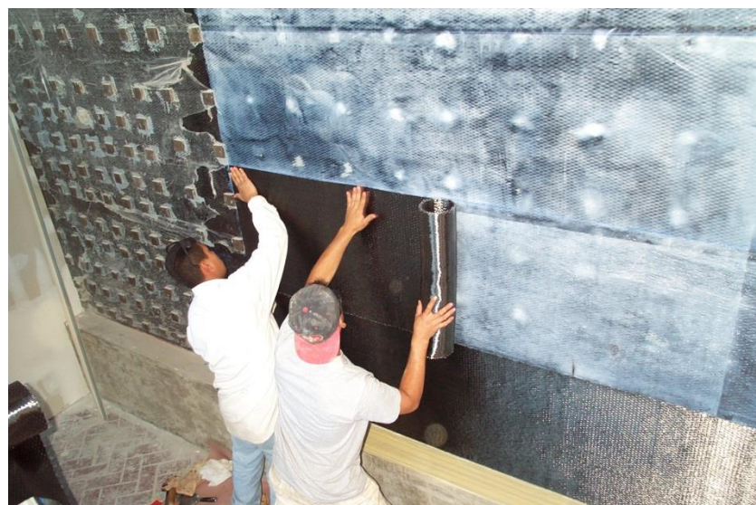
Figuur 57: Versterking van een 'shear wall' (versterkingsmuur die veel in aardbevingsgevoelige constructies wordt toegepast) met koolstof-composiet [5]
